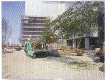
☆4 スカイアリーナ施工風景 スカイアリーナは緊急時の避難場所として想定されている。ヤマザクラ、イロハモミジ、コナラ、アオハダ、オオモミジなどが、数本ずつの群となって植栽されている
